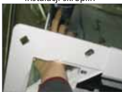
Otwór kontrolny przyłącza instalacji skroplin
